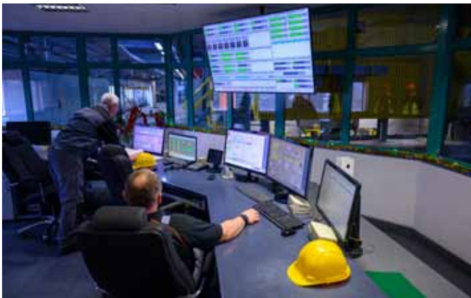
Nowoczesna sterownia pozwala na zarządzanie z jednego miejsca wszystkimi procesami w unowocześnionych kotłach Elektrociepłowni Piaskówka
